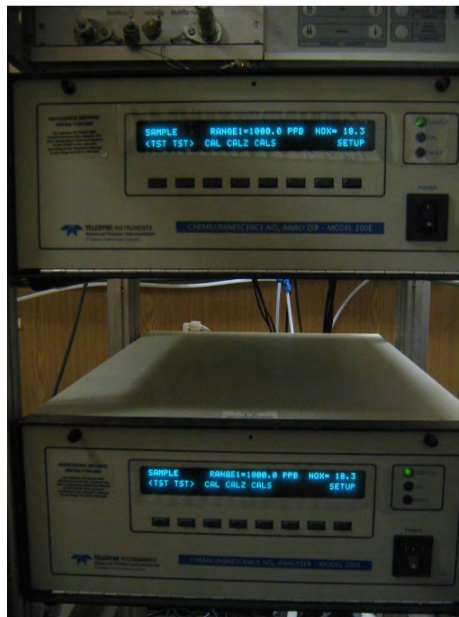
Abbildung 7: Frontaufnahme der im Messcontainer installierten Messeinrichtungen
