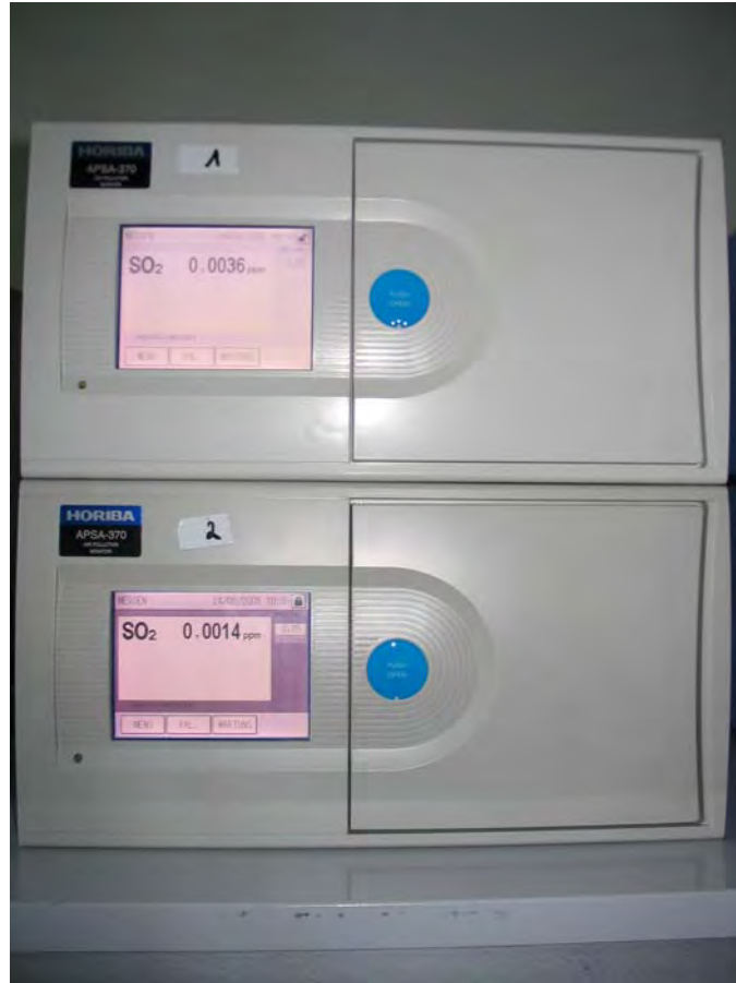
Abbildung 2: Frontaufnahme der im Messcontainer installierten Messeinrichtungen
